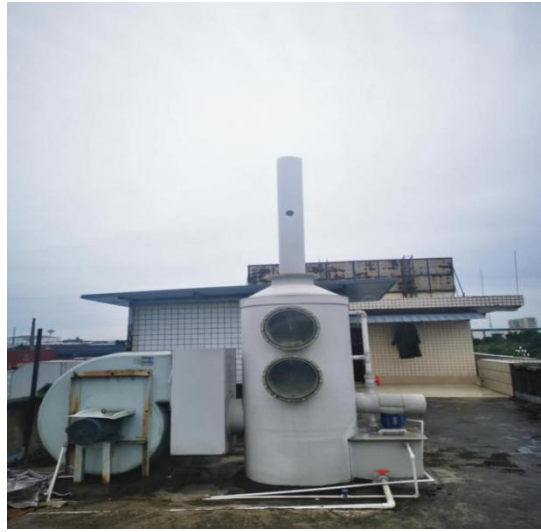
酸雾废气水喷淋进化塔
