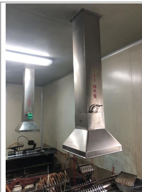
灌封废气收集装置
