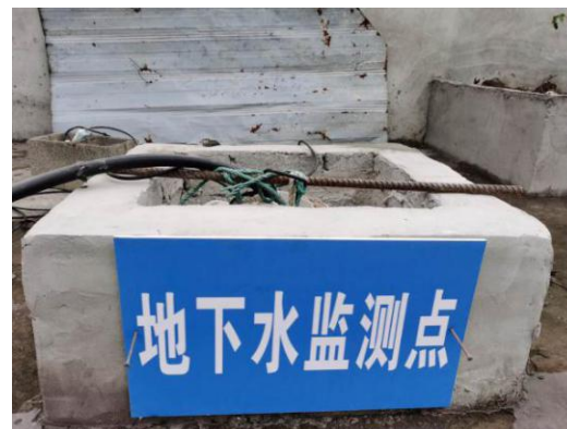
地下水监测井
