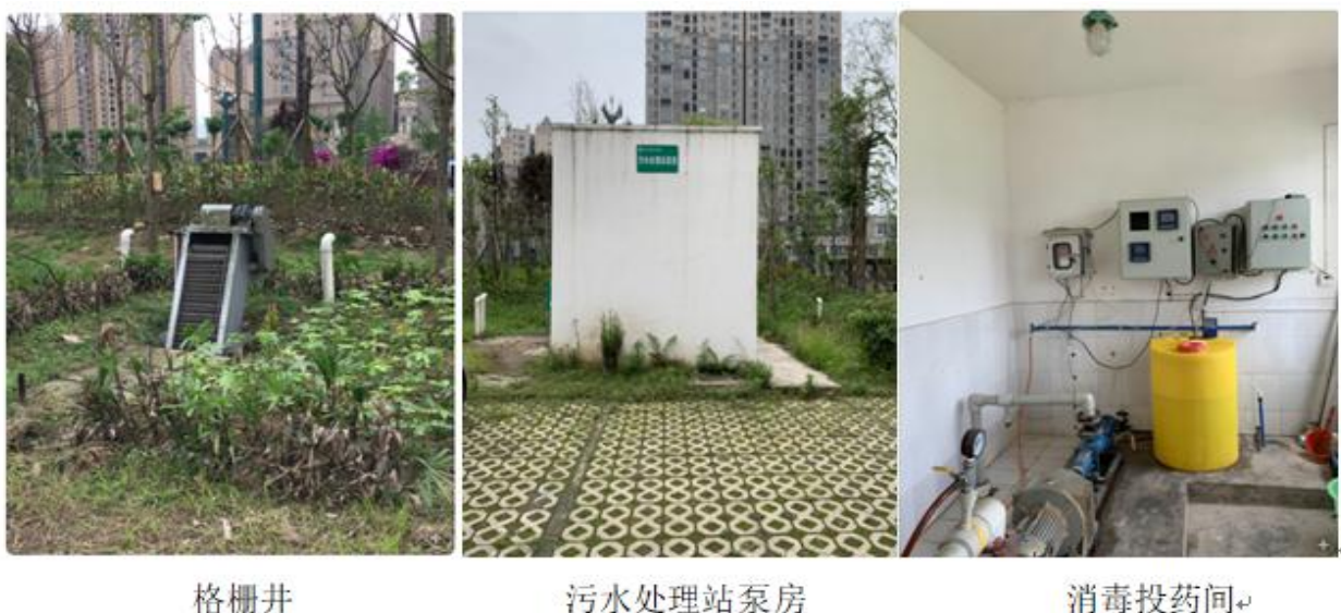
图4-2 废水污染防治设施现场图
