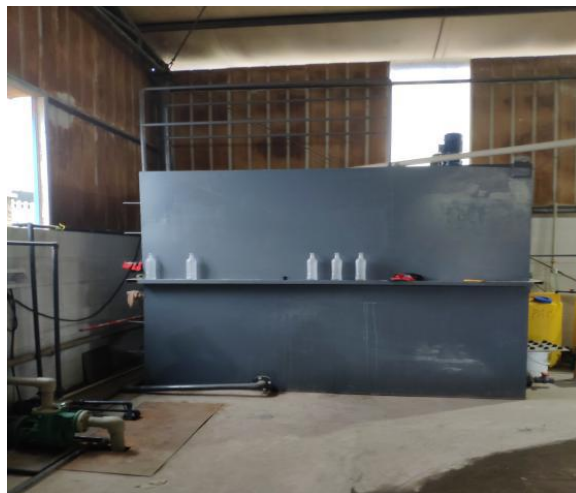
废水处理设施
