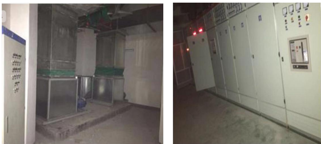
图 4-4 通风设备软管及密闭安装的变电箱
