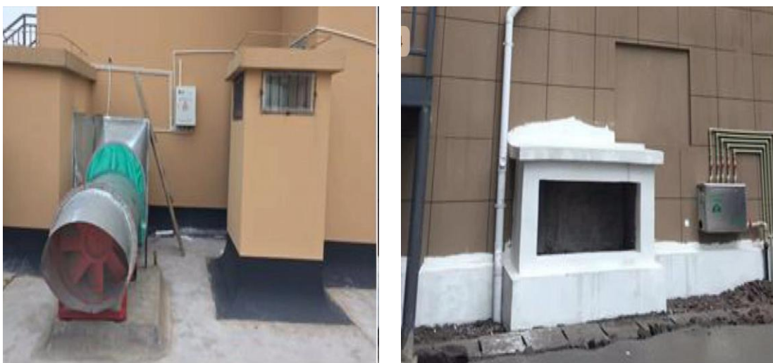
图 4-3 消防排风机出风口及地下室排气口
