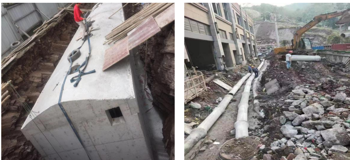
图 4-2 本项目污水预处理池及污水管网
